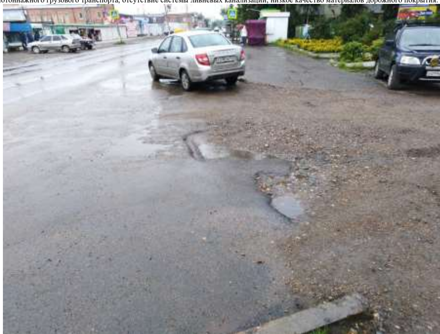
Рисунок 5.1 – Дефекты дорожного покрытия (ул. Московская, вблизи дома №67/1)
