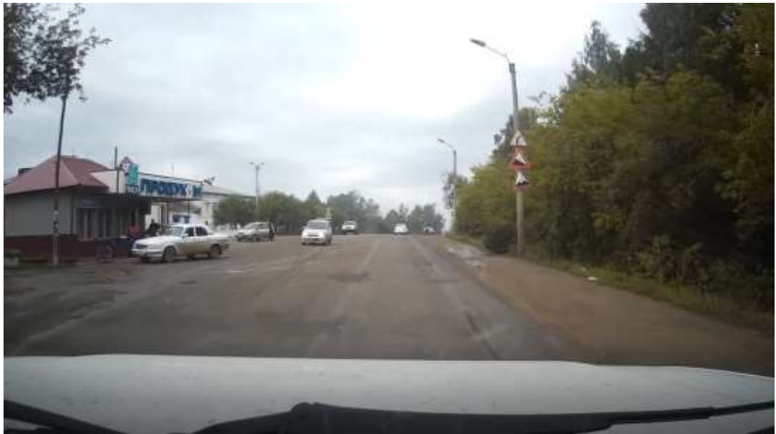
Рисунок 5.4 – Дефекты дорожного покрытия на ул. Декабристов (неудовлетворительное состояние обочин, выкрашивание, коллейность)
