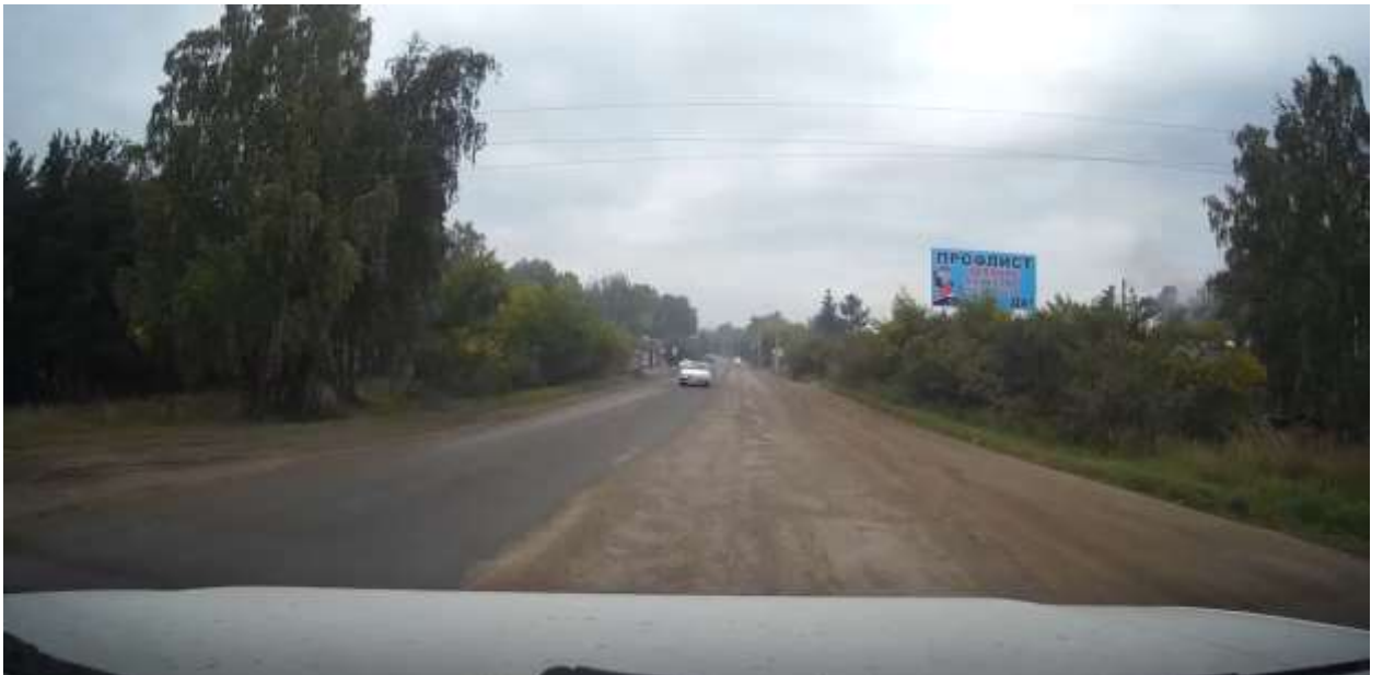
Рисунок 5.5 – Дефекты дорожного покрытия ул. Декабристов (неудовлетворительное состояние обочин, выкрашивание, коллейность)
