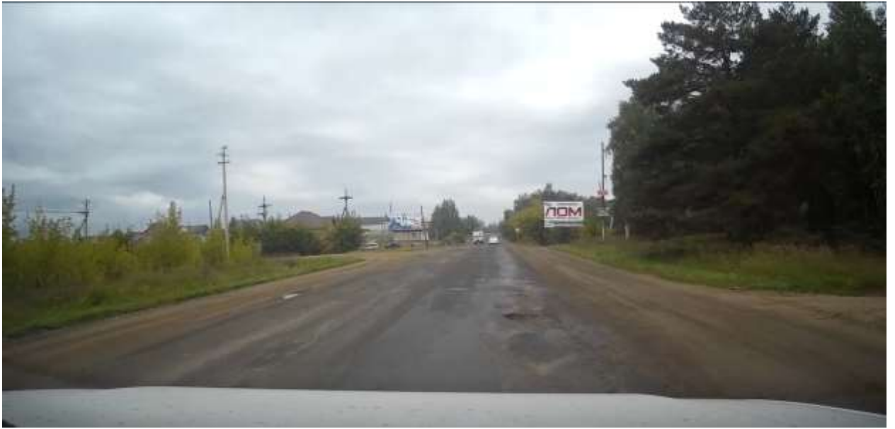
Рисунок 5.3 – Дефекты дорожного покрытия на ул. Декабристов (проломы, выкрашивание, коллейность)
