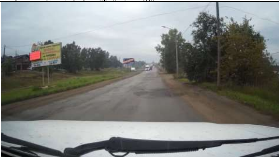
Рисунок 5.6 – Дефекты дорожного покрытия (просадка покрытия)
